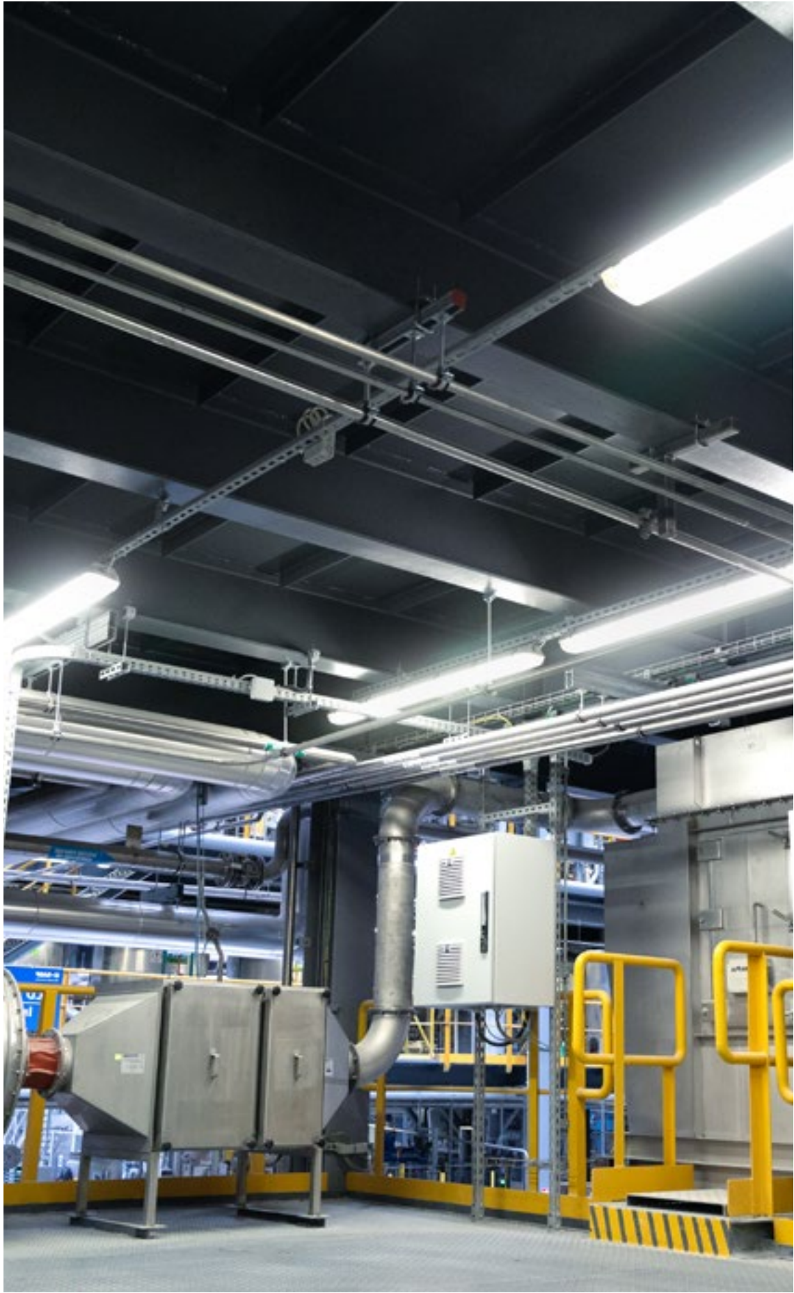
Einsatz von Tytan Multi LED Chemolampen in der Produktionshalle
