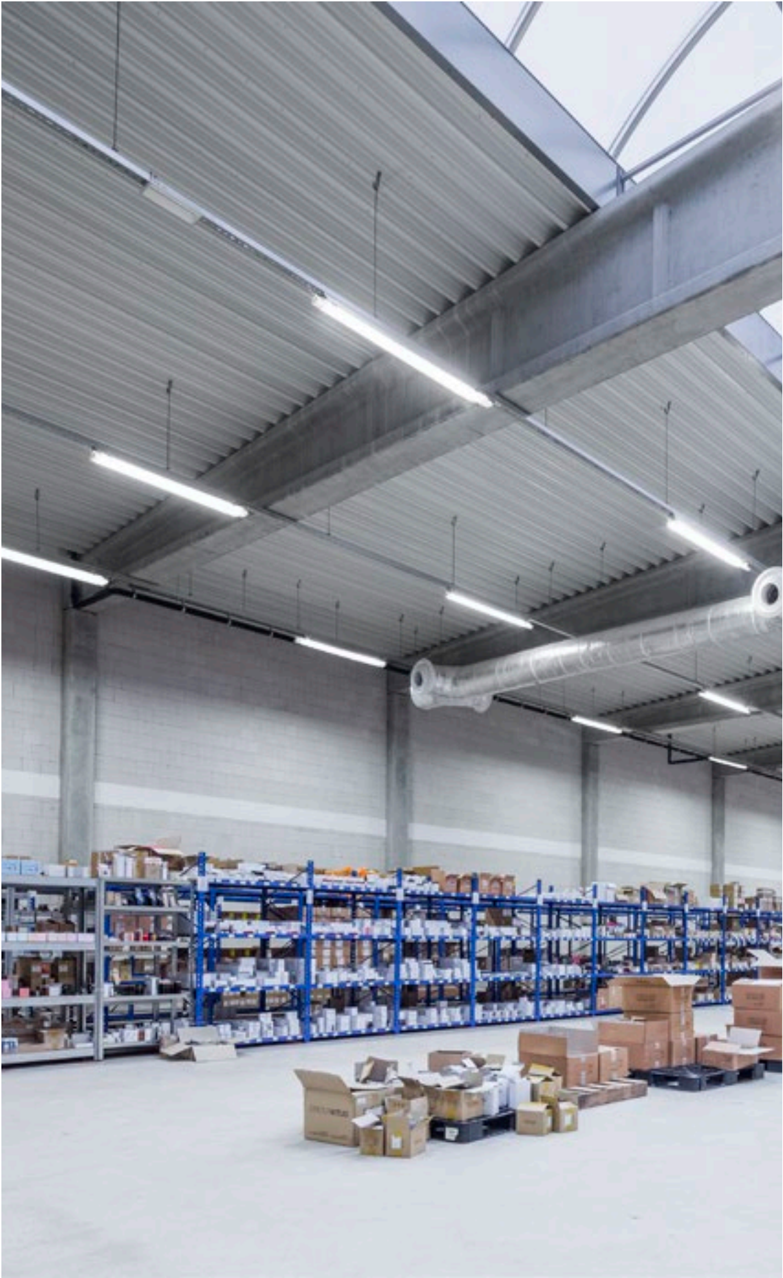
Der Einsatz von MIMO 2 LED Lampen im Lager
