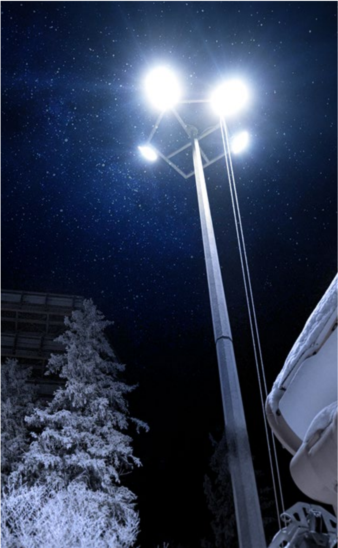
Beleuchtung der Skipiste Stotwiny Arena
