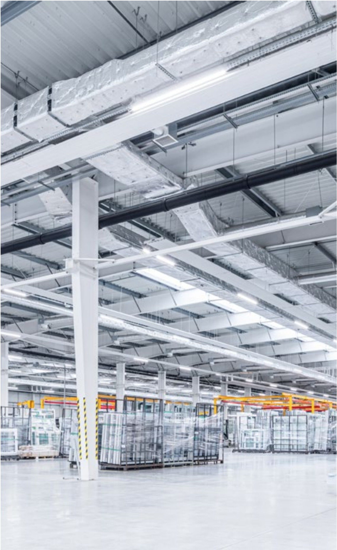
Einsatz von Linero LED-Leuchten im Lager
