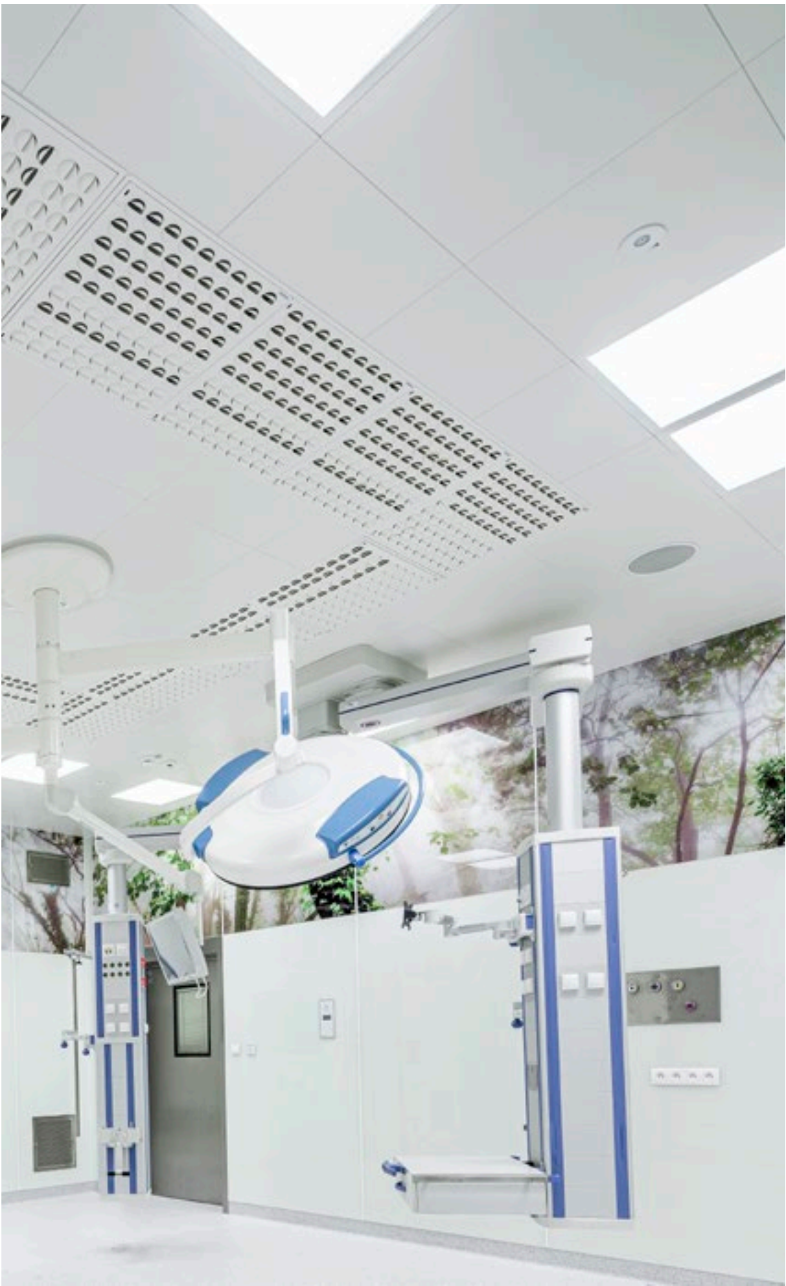
Lumedic-Leuchten im Krankenhaus
